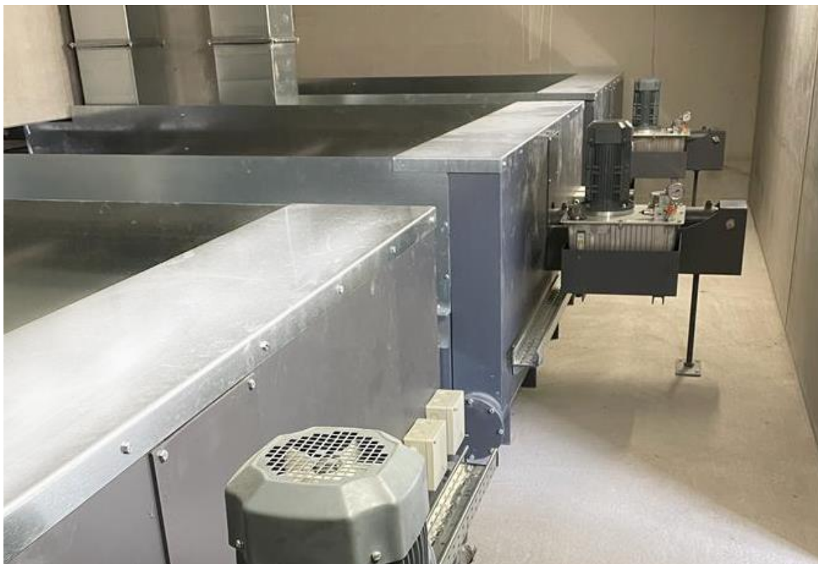
Beispiel: Projektspezifische Aufstellung von drei Schubodentrocknern.
